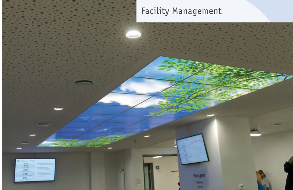
Auch die Ruhe- und Aufwächerräume erhielten die neuen Lichtdecken.
